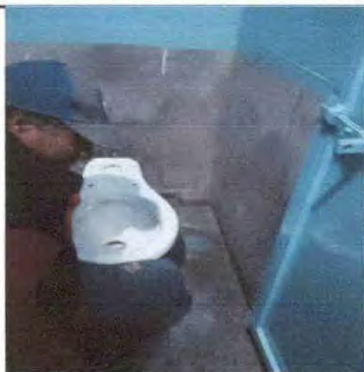
Foto 3: SERVICIOS SANITARIOS Y SUS ACCESORIOS
